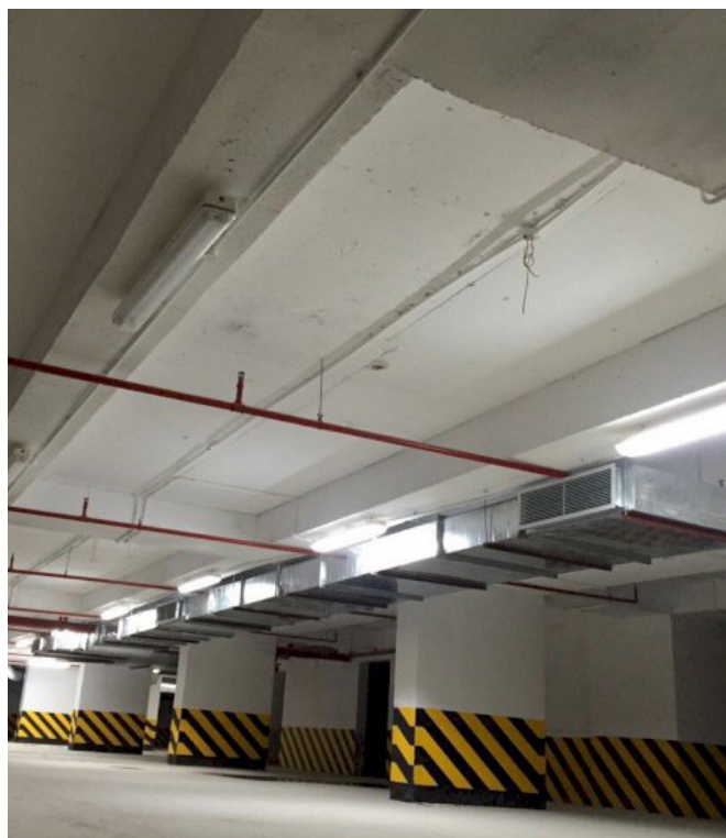
Hệ thống quạt hút tầng hầm
