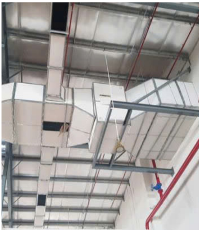
Hệ thống quạt hút PCCC
